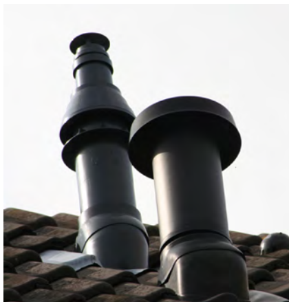
-Figuur 2- Het voorschrift voor de dakuitmondung van ontspanningsleidingen is in de eerste tien jaar van NEN 3215 meerdere keren aangepast. In 1997 is het voorschrift zodanig aangepast dat een uitmondung in een dakpan niet voldoet.
