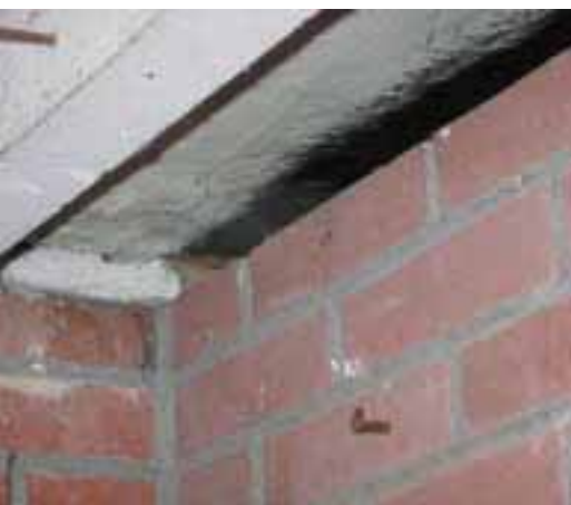
Grote openingen ter plaatse van aansluiting bouwmuur op plat dak.
