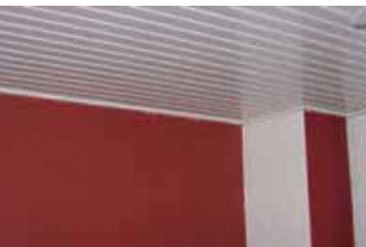
Om te controleren of de bouwmuur boven het plafond onvolkomenheden bevat is in de meeste gevallen nader onderzoek nodig met een endoscoop.
