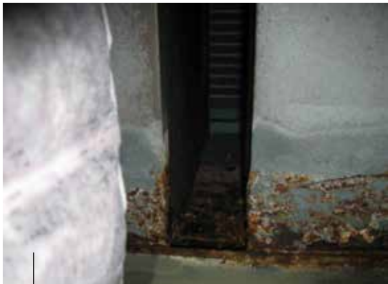
Figuur 1: Corrosie achter het filter
