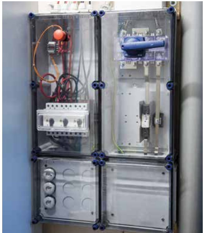
Op de DC-verdeler zijn de combinerboxen, bidirectionele omvormer en de accu op aangesloten en met elkaar verbonden.
