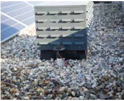
Via een dakdoorvoer wordt de opgewekte stroom naar de appartementen gevoerd.
